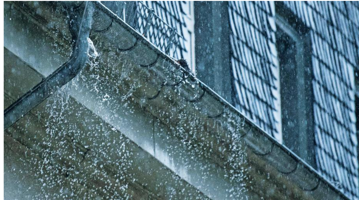
Bei einem Gewitter können große Regenmengen in kurzer Zeit fallen - man spricht dann von Starkregen
